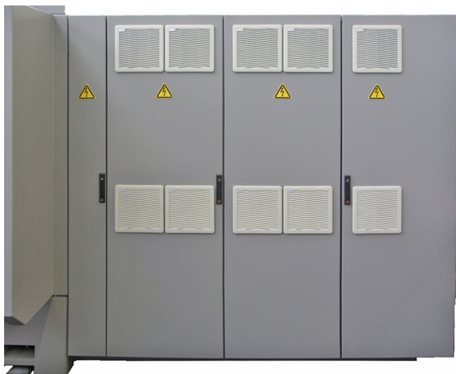
Exemple : Filtres de l'armoire électrique
